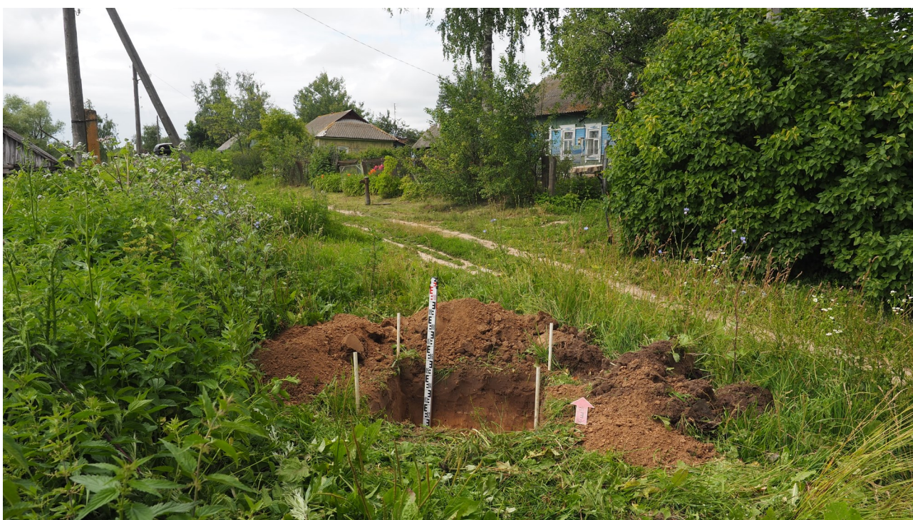
Рис. 36. Калужская область, Мещовский район. 2023 г. Археологическое обследование по объекту: «Уличные газопроводы дер. Высокое». Вид на раскопанный шурф 2 с юга.
